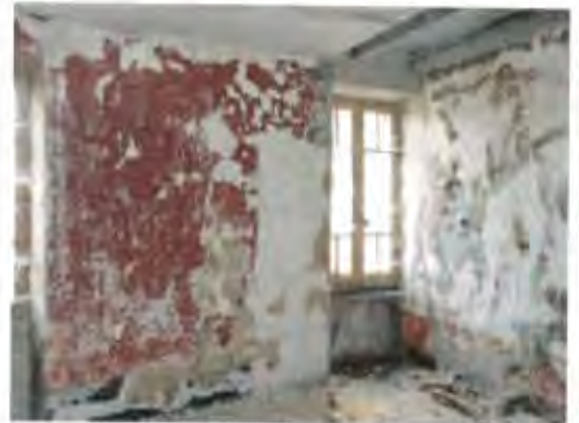
Exemple de logement vacant et dégradé par le manque d'investissement dans des travaux
