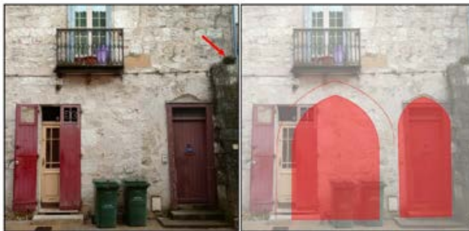
20- Vestiges des ouvertures primitives (grande arcade boutique et porte) au rez-de-chaussée de la façade ouest. Le corbeau (indiqué par la flèche rouge) pourrait correspondre à un support pour un auvent qui devait protéger les ouvertures du rez-de-chaussée (cliché et infographie David Souny).
